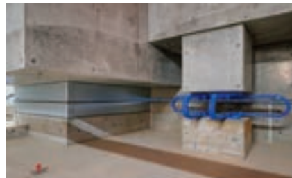
▲積層ゴム支承と鋼製U型ダンパー
